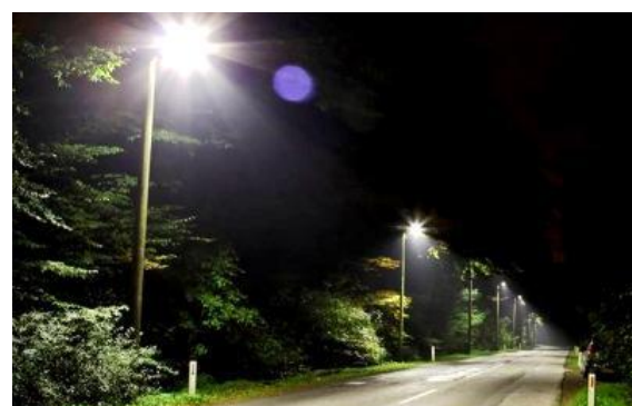
Luminaires sur mât 377
